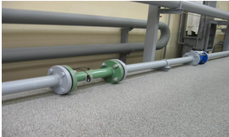
Рисунок 3.3 Ультразвуковой и турбинный водомеры на подающей магистрали
